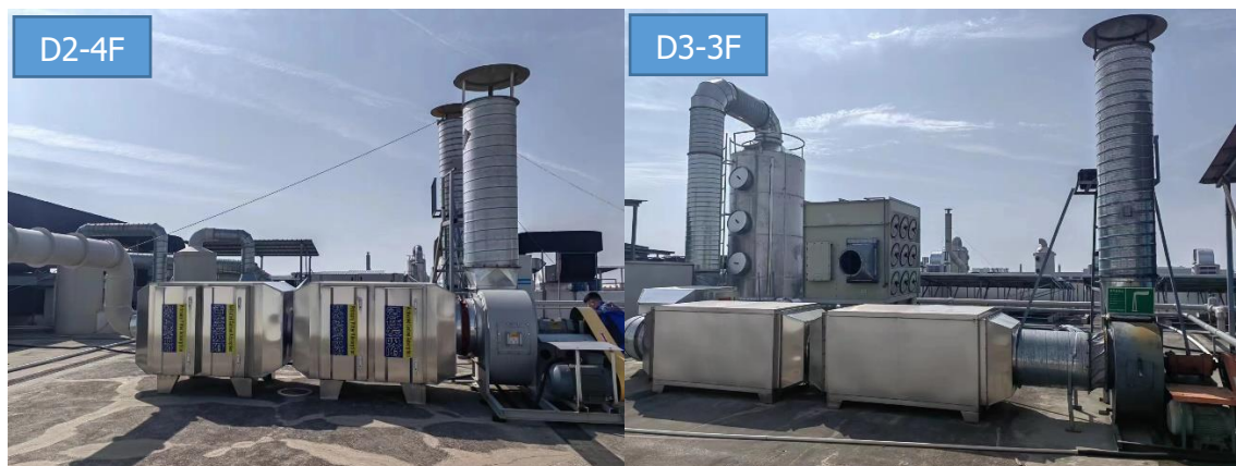
图 3-2 废气治理设施现场照片
