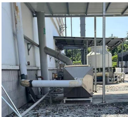
废气处理设备
