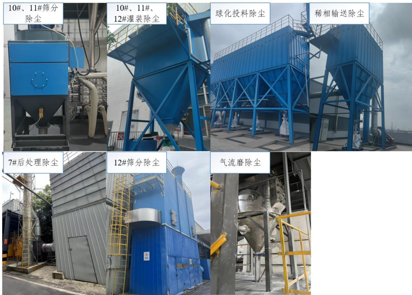
图 3-2 废气处理设施现状
