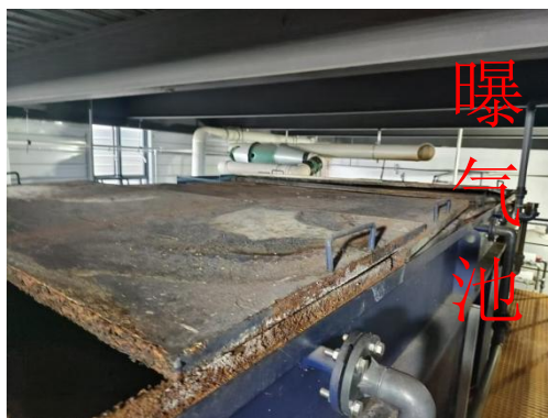
图 3-2 废水处理设施现状
