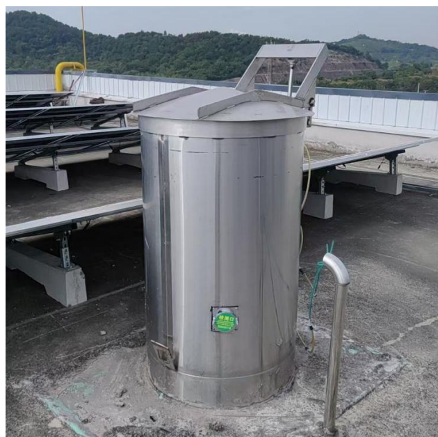
图 3-6 喷雾干燥废气排气筒
