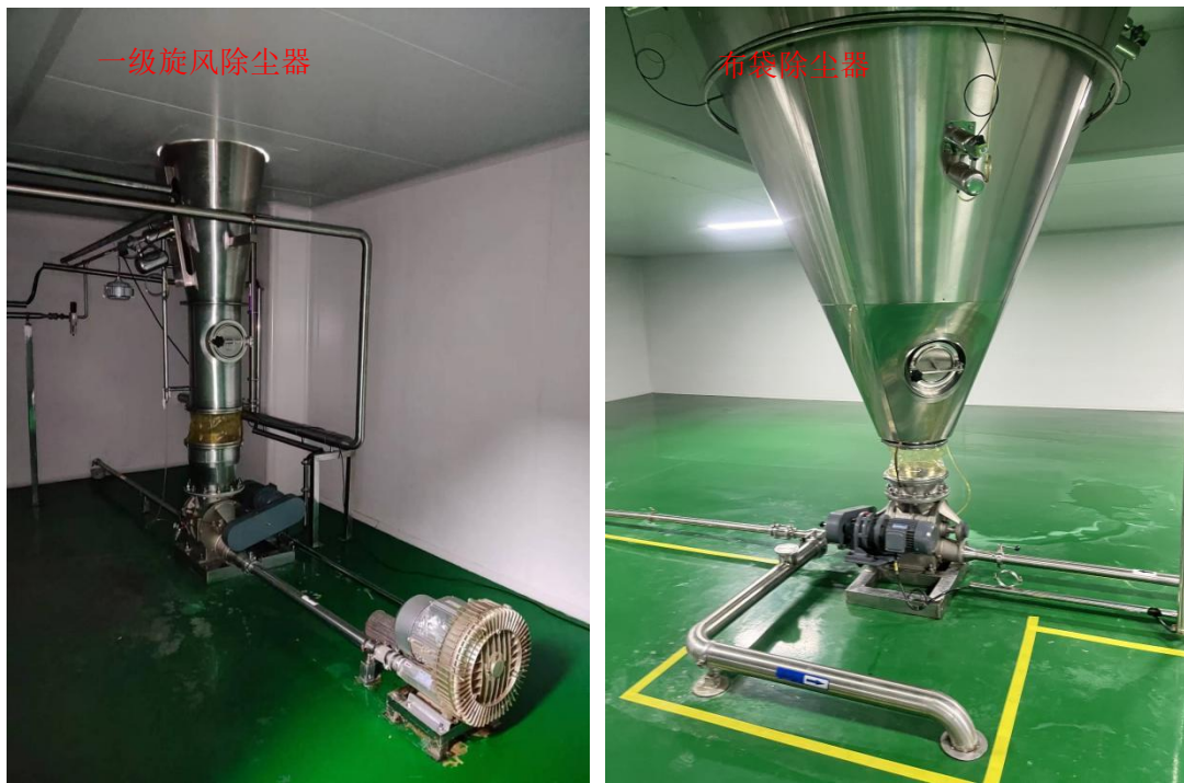
图 3-4 有组织废气处理设施现场照片
