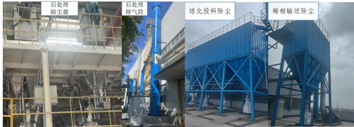
图 3-2 废气处理设施现状
