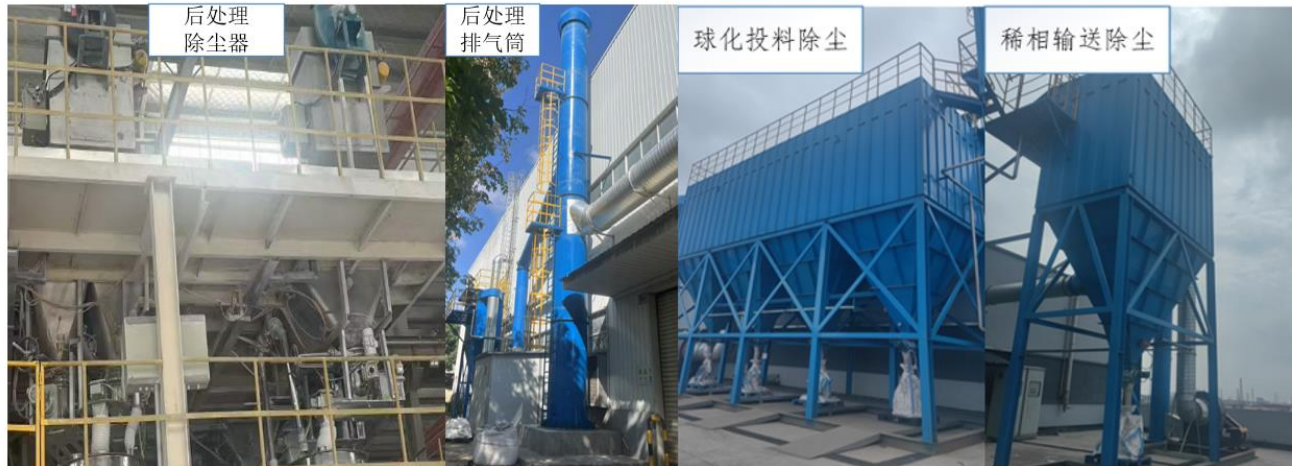
图 4-2 废气处理设施现状
