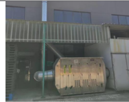
废气处理设施
